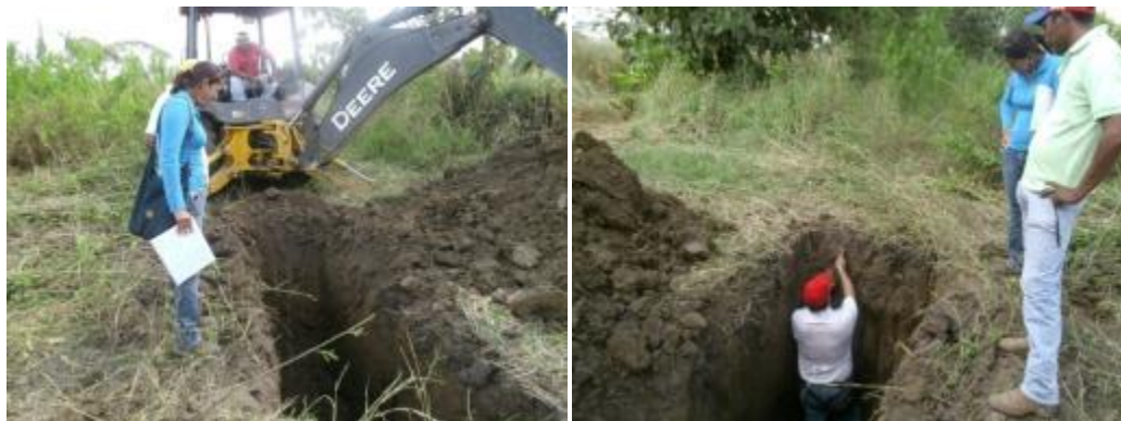
Figura 2. Construcción de calicata en el terreno aledaño al vertedero de Guanarito, municipio Guanarito, estado Portuguesa.
