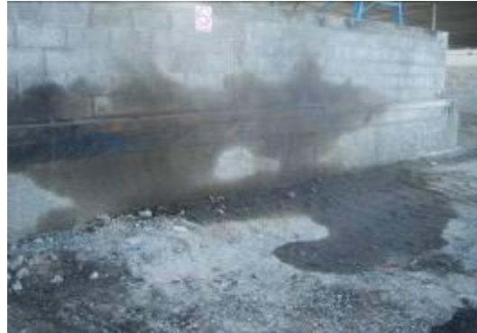
Figura 21. Manchas de combustible, en el área de abastecimiento.
